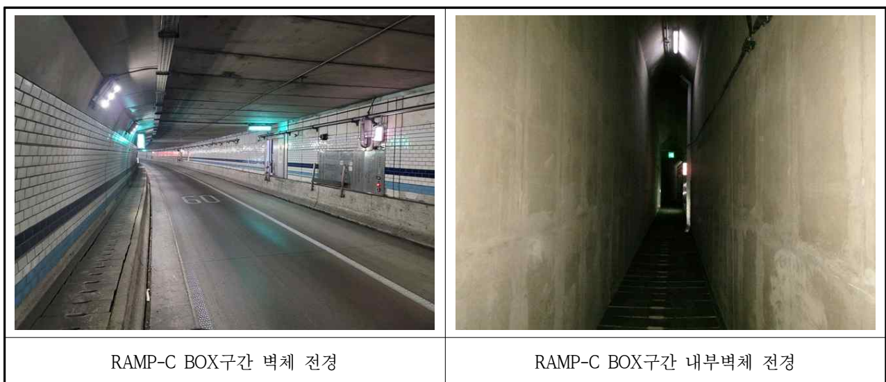
【사진 3.3.22】 BOX구간 벽체 손상현황
