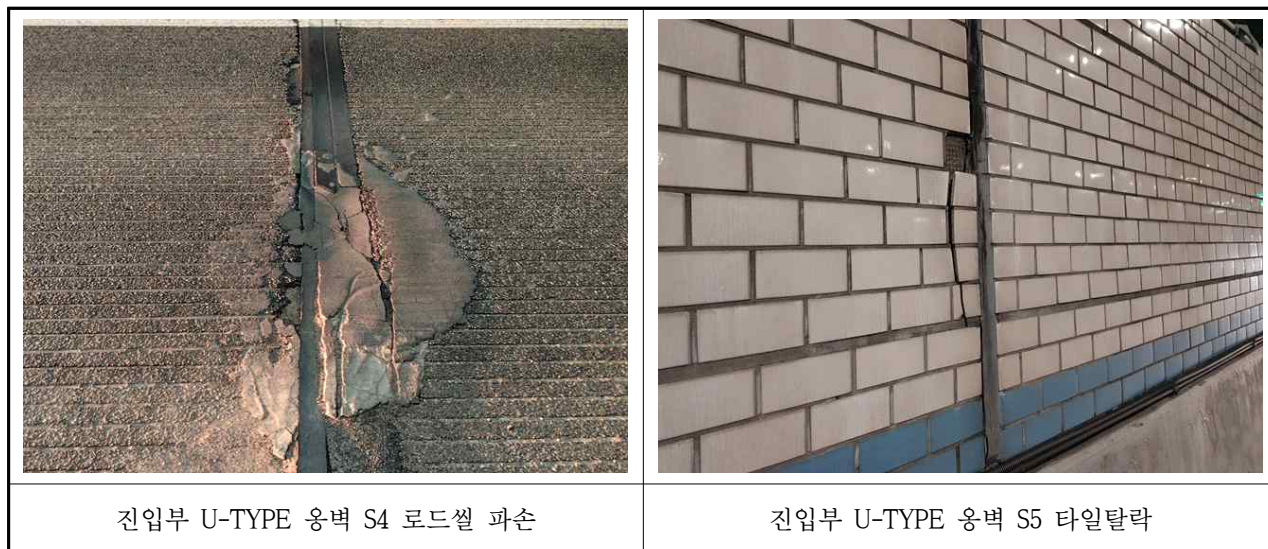
【사진 3.3.42】 U-TYPE 옹벽 손상현황
